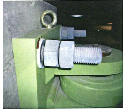
(オイルダンパーのボルトの緩み)
