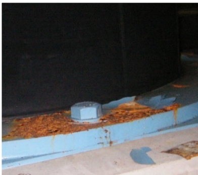
(積層ゴムフランジ PL の発錆) [図 5-2 免震部材の発錆]
